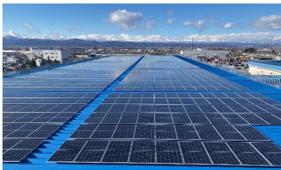
山形工場の太陽光パネル
